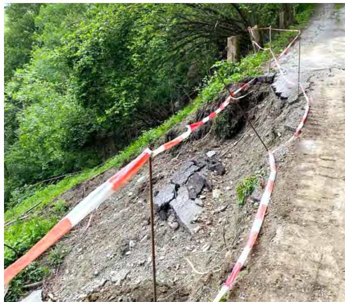
Hangrutschungen bei der Verbindungsstraße Lend-Böndlsee.
